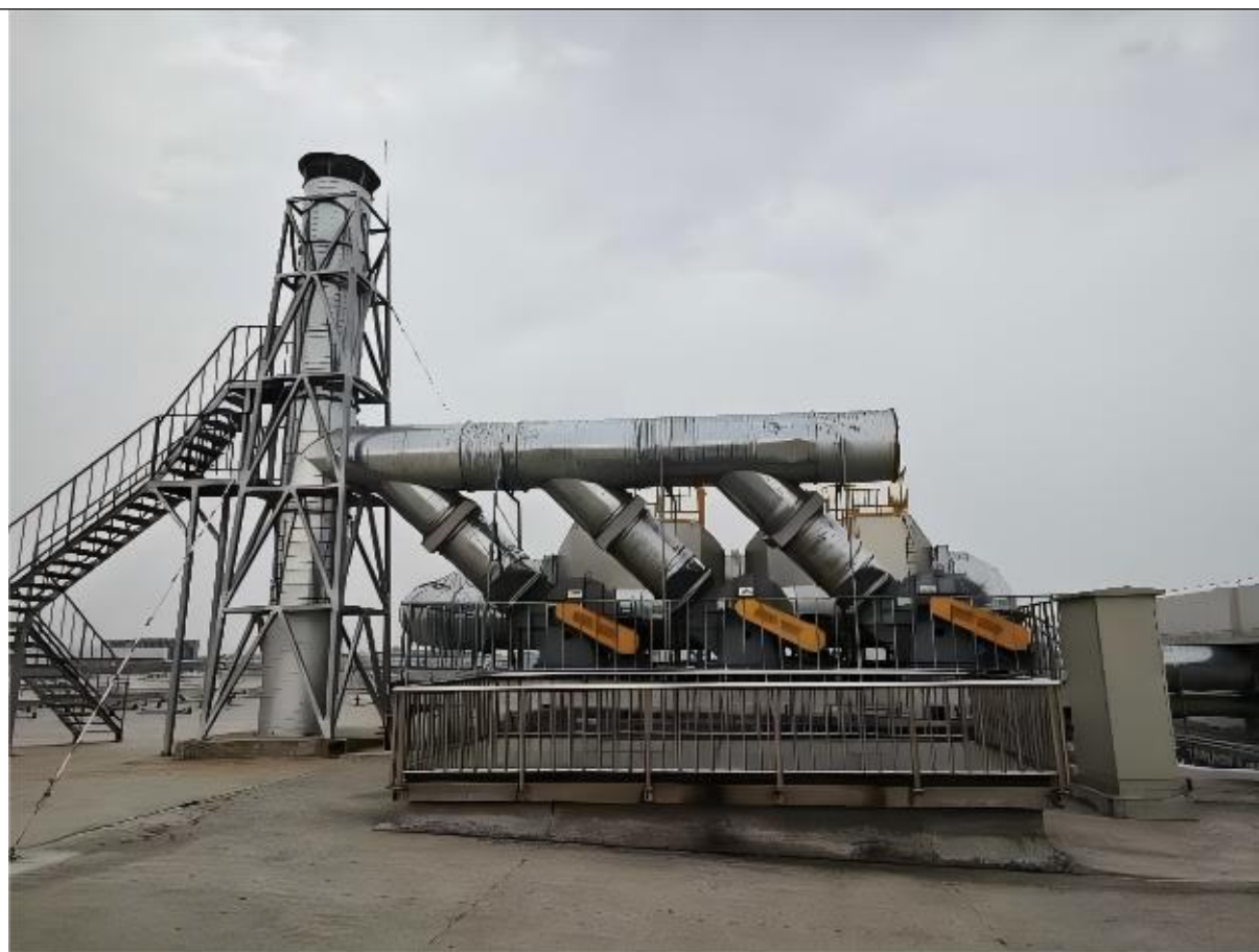
福米公司双极活性炭处理设施
