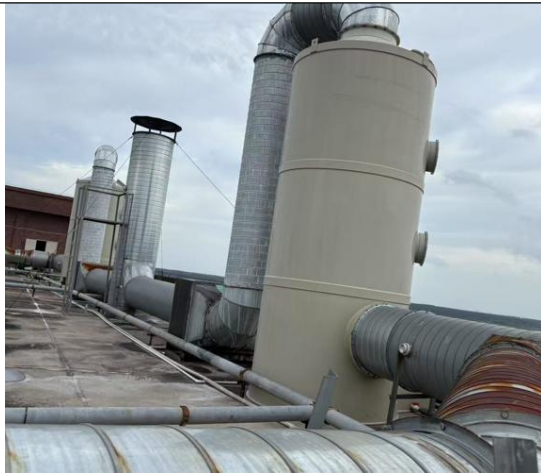
现有工程 DA003 排气筒（湿式除尘+静电除油）
