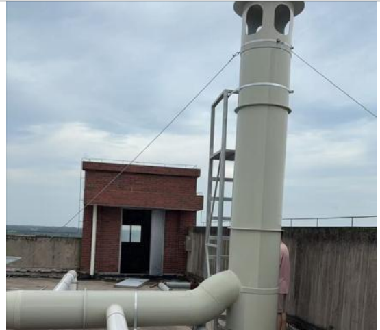
现有工程 DA006 排气筒（水喷淋（内置））
