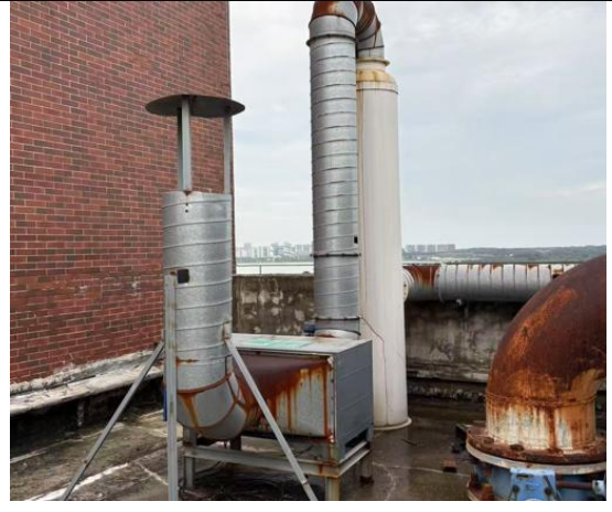
现有工程 DA002 排气筒（离子除臭+水喷淋装置）
