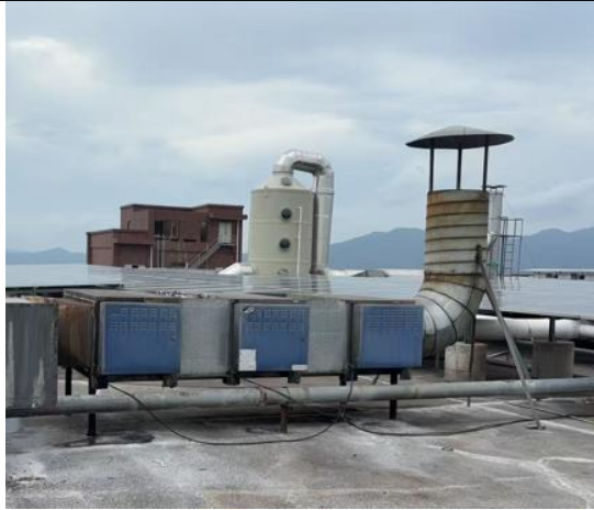
现有工程 DA001 排气筒（静电除油装置）
