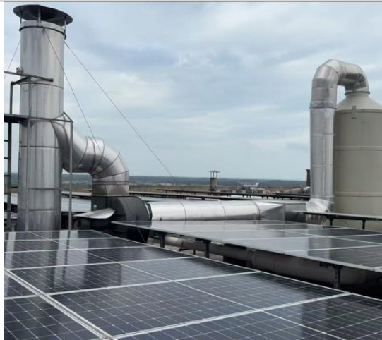
现有工程 DA005 排气筒（水喷淋+静电除油装置）
