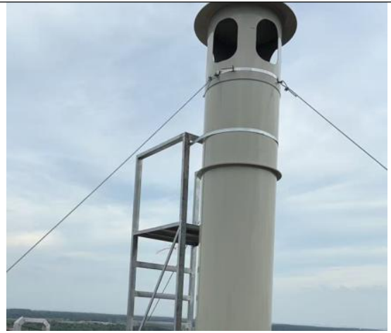
现有工程 DA004 排气筒（水喷淋（内置））
